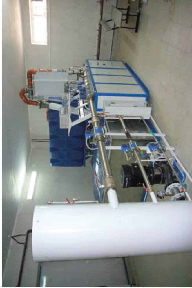
Установка «ВПУ-Энерго» с диаметрами условного прохода поверяемых счетчиков – до 100 мм, максимальный воспроизводимый расход – 110 куб.м/ч
